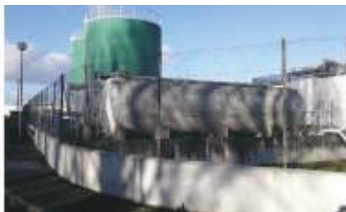
(3) Cuves aériennes de fuel pour la chaufferie et les groupes électrogènes - Source : Antea Group, février 2019
