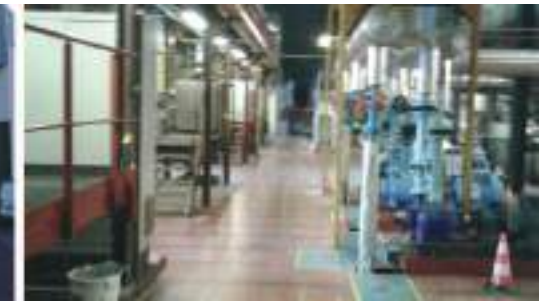
Intérieur de la chaufferie - Source : Antea Group, février 2019
