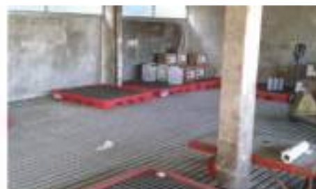
Stockage de produit sur bac de rétention - Source : Antea Group, février 2019
