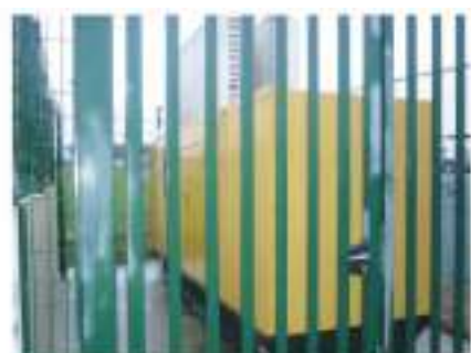
photo n° 9 : groupe électrogène auxiliaire pour le secours de la dalle fluide
