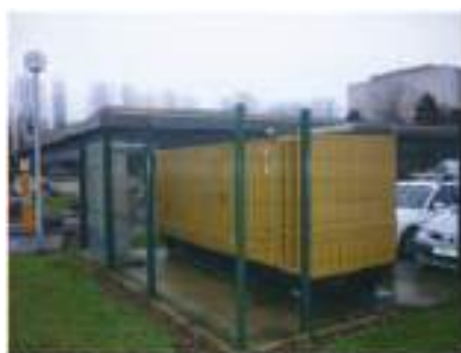
photo n° 8 : groupe électrogène auxiliaire pour poste de livraison
