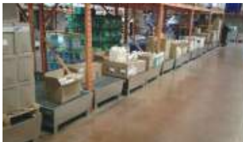
Stockage de produit sur bac de rétention - Source : Antea Group, février 2019
