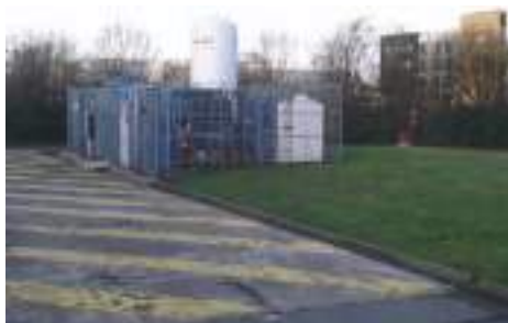
(1) Stockage de gaz sur dalle fluide - Source : Antea Group, février 2019
