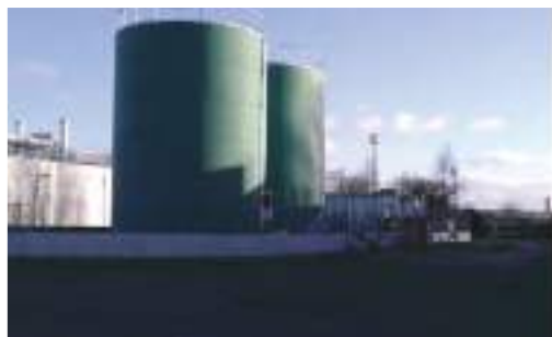
(2) Cuves aériennes de fuel pour la chaufferie et les groupes électrogènes - Source : Antea Group, février 2019
