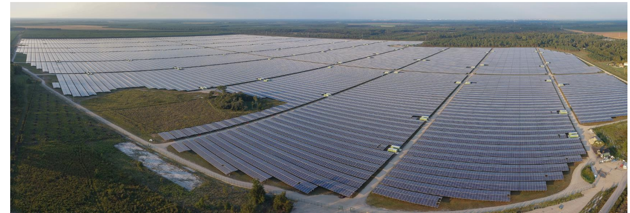
Figure 12 : Parc photovoltaïque de Cestas – septembre 2015 (source : Neoen, 2017)
