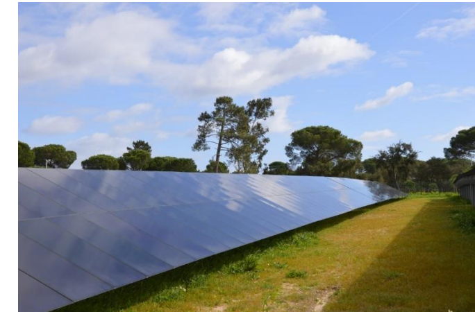
Figure 23 : Exemple d'une rangée de modules (source : NEOEN, 2018)
