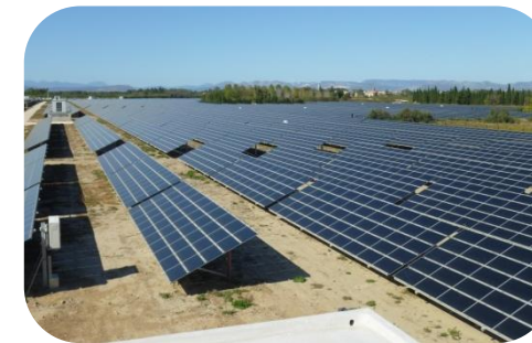
Centrale Solaire de Toreilles (12 MWc)
