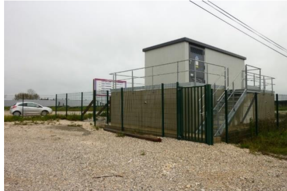
Figure 25 : Illustration d'un poste de livraison (source : NEOEN, 2018)
