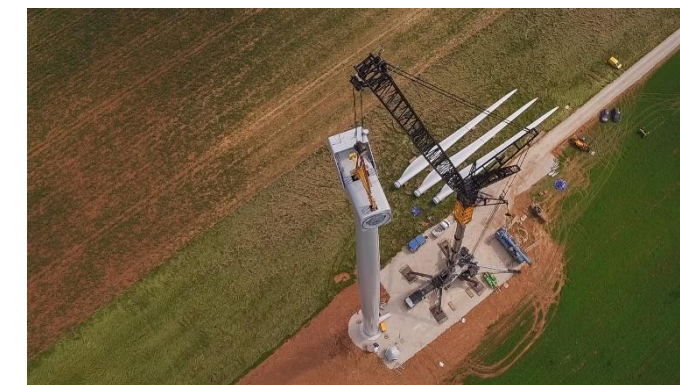
Figure 17 : vue du montage de l'éolienne n°10 (source : Neoen, 2017)
