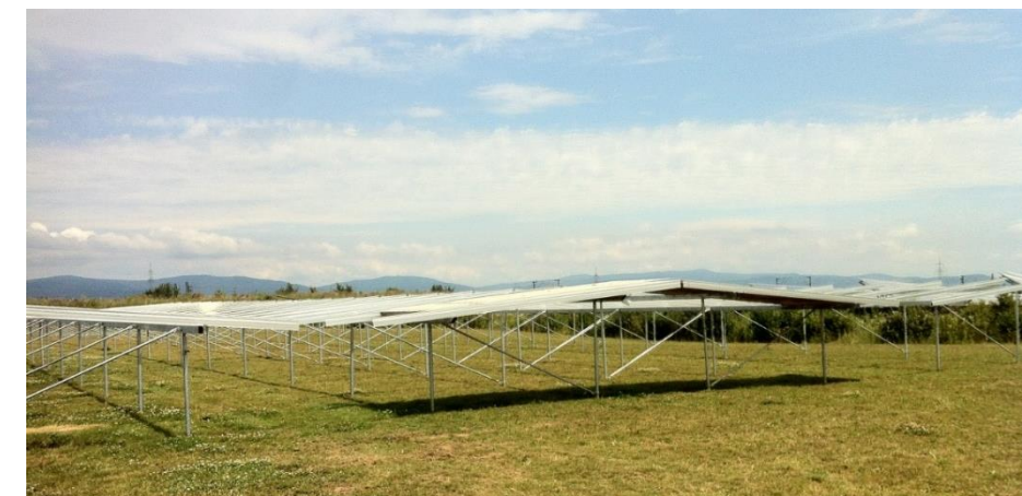
Figure 24 : Structure de tables dans une orientation est-ouest (source : NEOEN, 2018)
