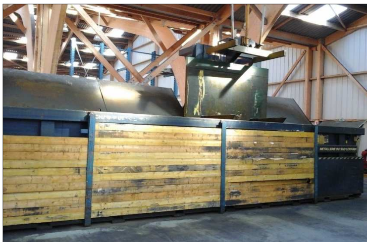
Photographie 2 : Vue du bac de trempage
