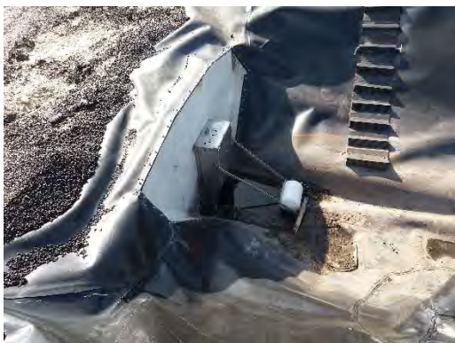
Photographie 3 : Vanne de confinement de la zone Sud
