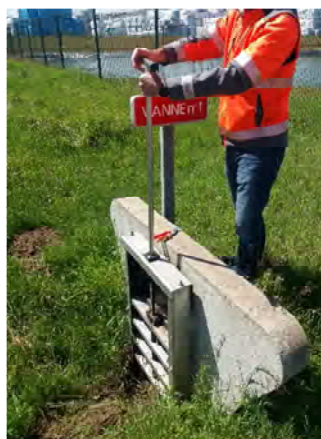
Photographie 4 : Vanne de confinement de la réserve incendie de 800 m 3
