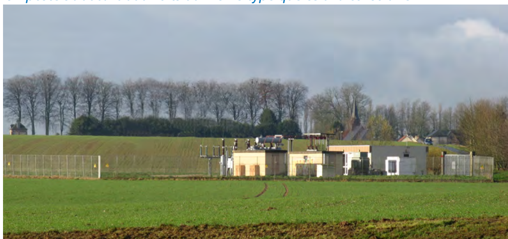
Un poste 90 000/20 000 volts du même type que celui à construire
