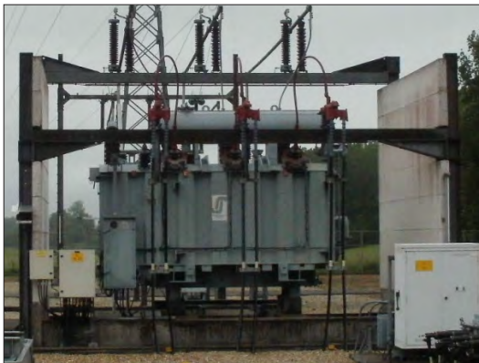
Un transformateur 90 000/20 000 volts et ses murs pare-feu
