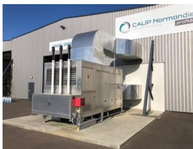
FIGURE 4 : CENTRALE DE TRAITEMENT D'AIR
