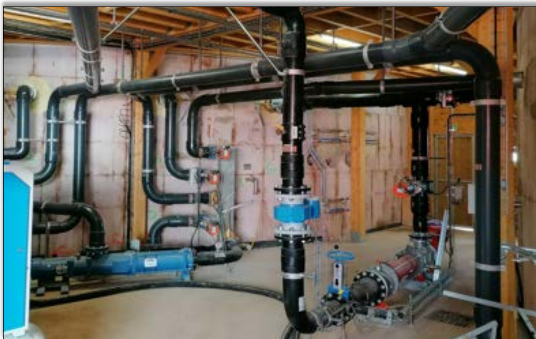
Exemple d'image: Système de pompage dans bâtiment intermédiaire
