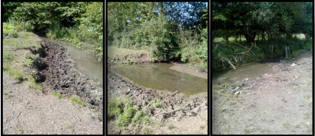
Figure n°5 : Dégradations des berges par le piétinement du bétail sur la Morte-Vie
